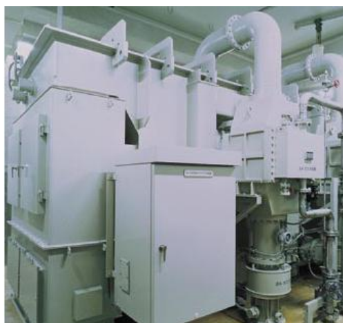
Figura 7 - Transformador elevador (23 – 107 kV), isolado a SF 6 – Japão.
